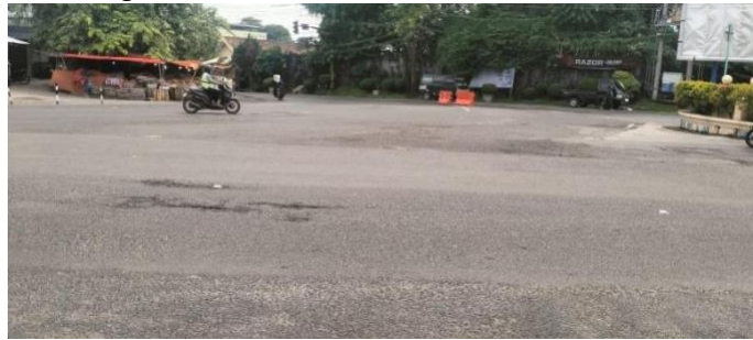
Gambar 4.5 Marka Jalan Tidak Jelas Terlihat
